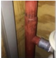
Foto 1 - Leiding met lekkende koppeling
