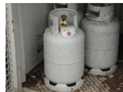
Opslag volle gasflessen
