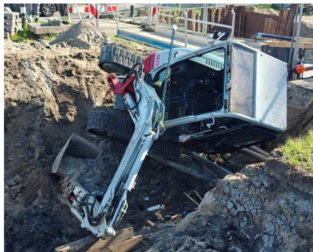
Foto: de graafmachine ligt op zijn kant door inkalving van de sleufwand.
